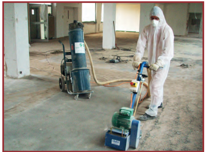
Asbesthaltiger Kleber in Fußböden gehört fachgerecht entsorgt
